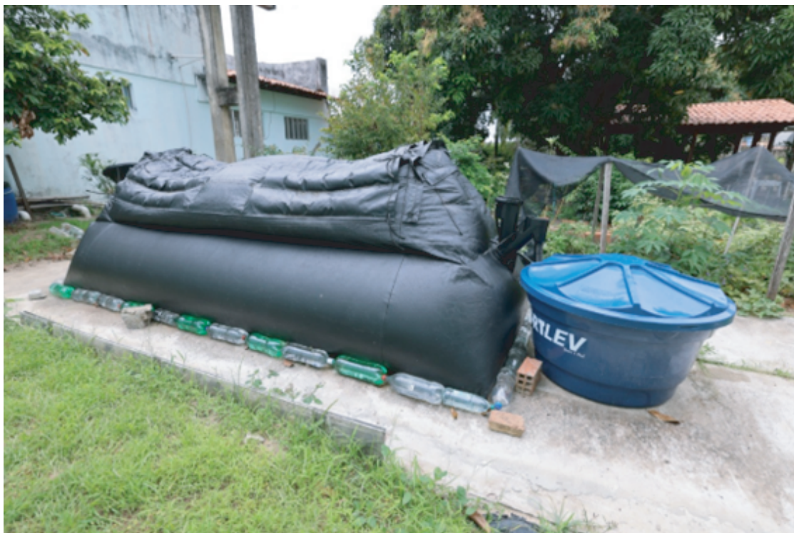
Biodigestor instalado no Oratório de Bebê
